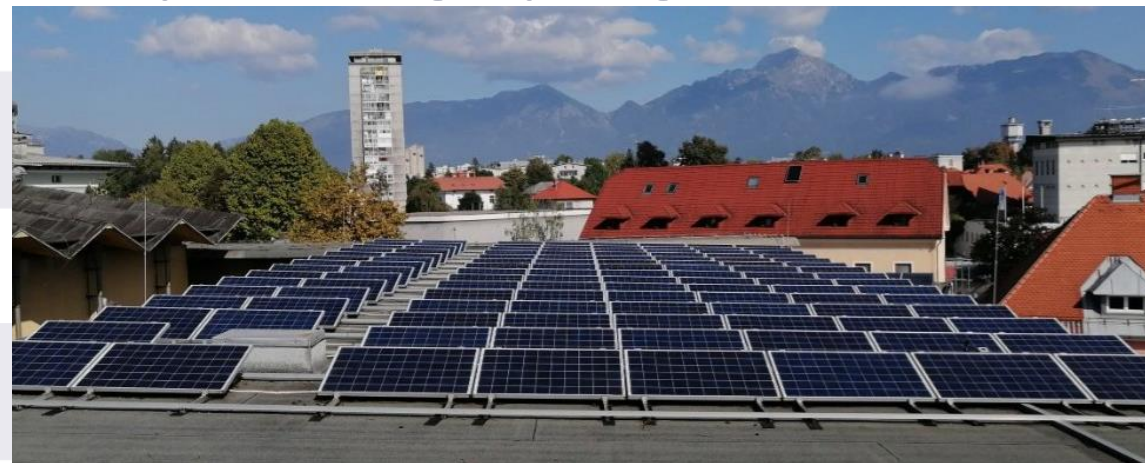
Sončna elektrarna na strehi upravne stavbe MOK
